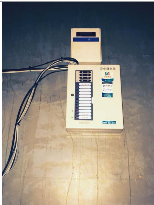
室內保全主機
