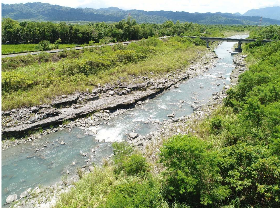
圖 4-14 馬遠大橋下游河道掏刷嚴重(2019.08)
